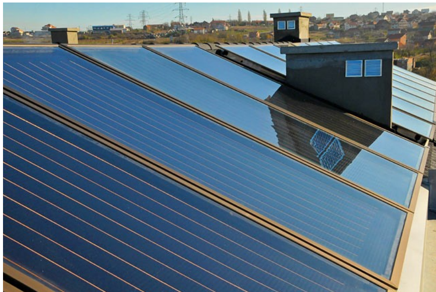
Solarni kolektori za zagrevanje potrošne tople vode (na krovu stambene zgrade)
