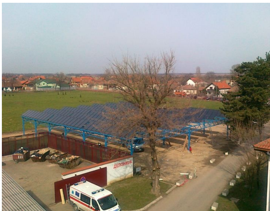
Solarni kolektori za zagrevanje potrošne tople vode za državnu bolnicu u Požarevcu (iznad parkinga za automobile)
